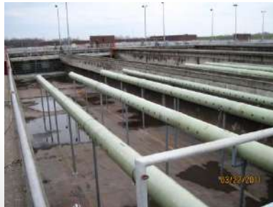
Effluent piping Indiana
